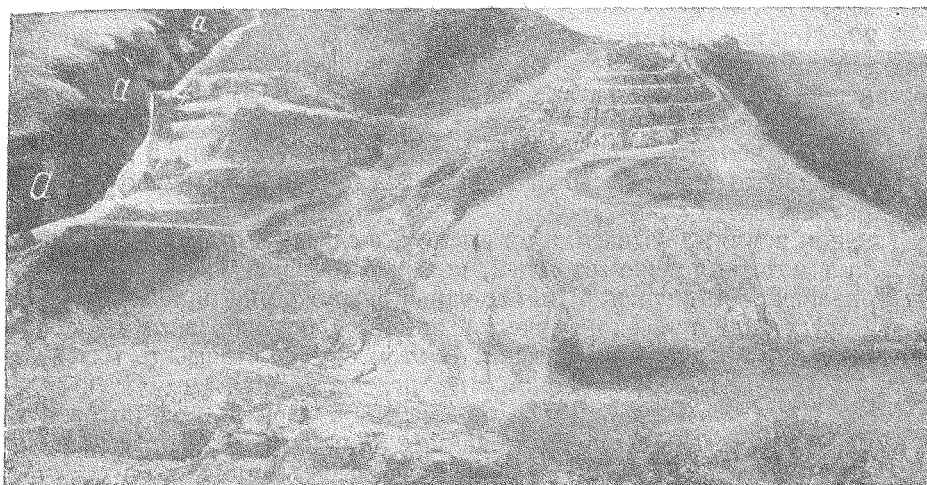
Фиг. 4. Буквами a—a показан овраг глубиною до 35 м., образовавшийся из нагорной канавы в лёссовом грунте
